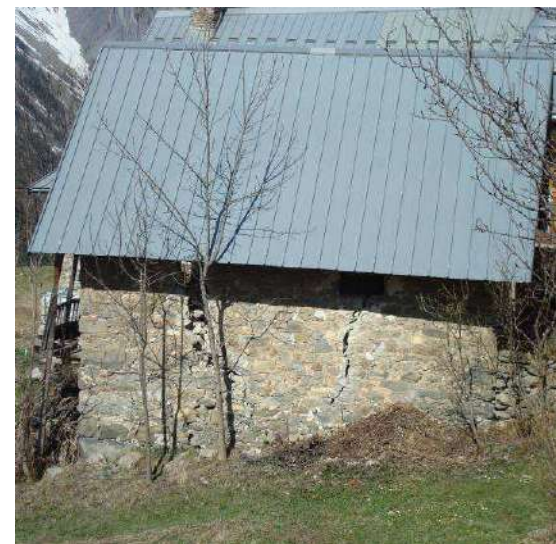
Fissures dans le centre du hameau
