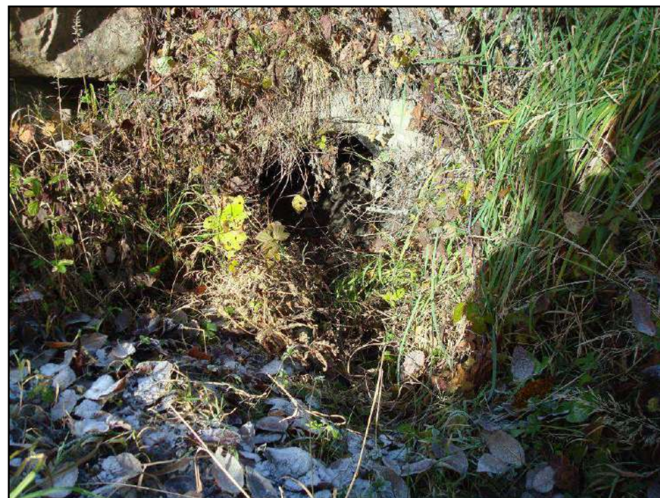
Buse encombrée dans l'entrée du hameau
