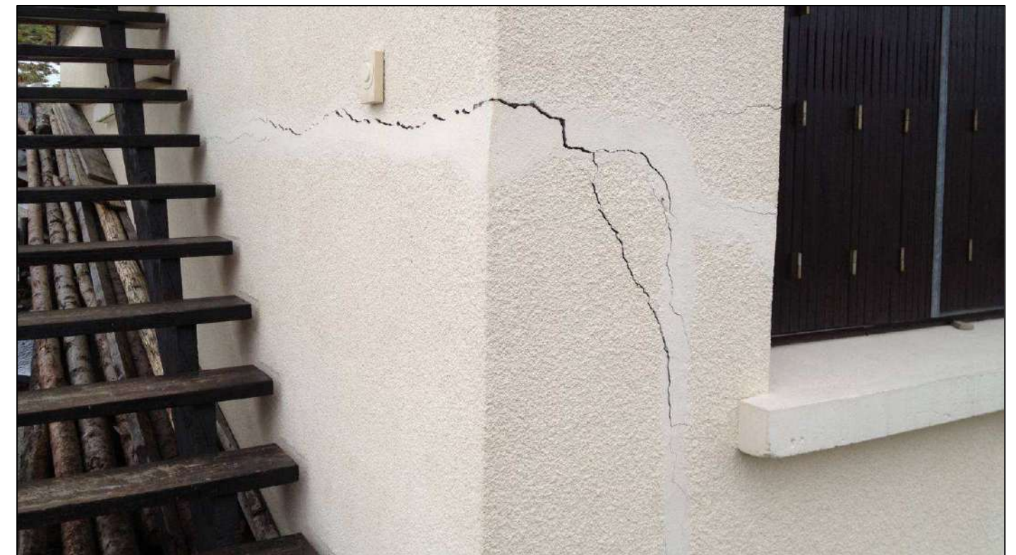
Désordres sur une habitation récente au nord immédiat du Chalmieu (G 4.4 )
